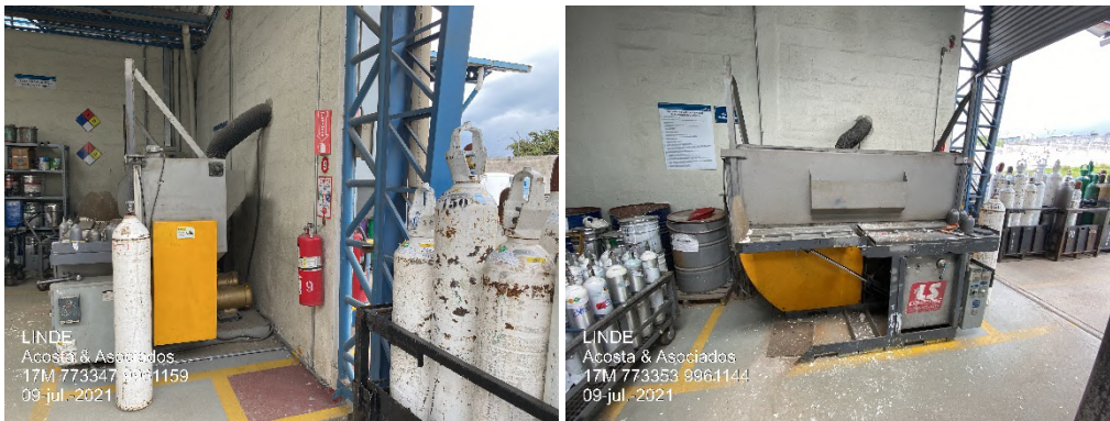
Ilustración 21. Área de Granallado
