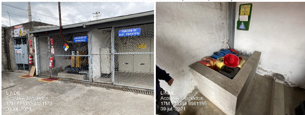
Ilustración 34. Almacenamiento de combustible, cubetos, MSDS y extintores
