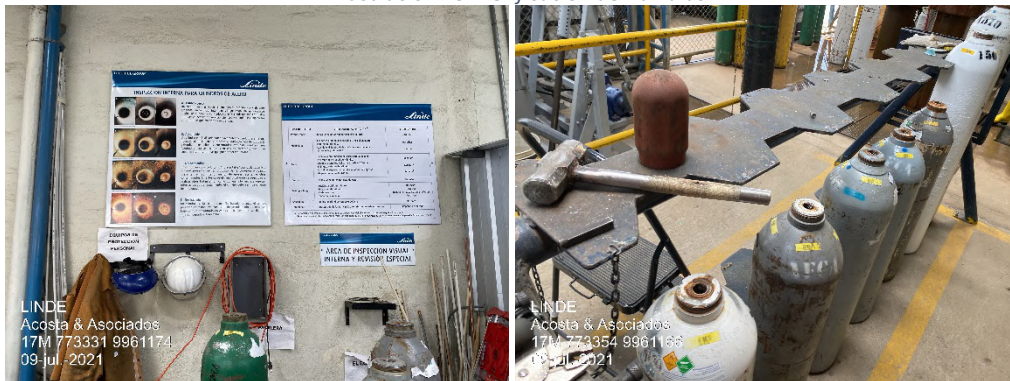
Ilustración 23. Verificación de Válvulas
