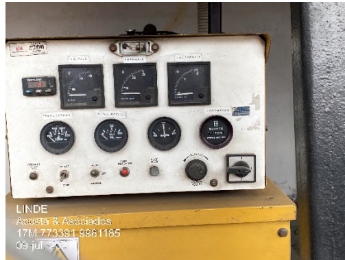
Ilustración 33. Horómetro del Generador eléctrico
